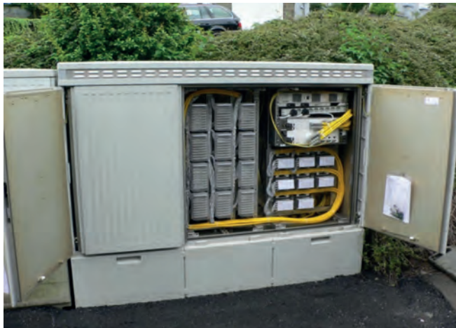
Εικόνα 5.1.4.1.β: Εξωτερικό DSLAM
