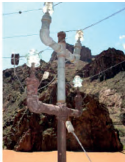
Εικόνα 5.1.α: Εγκατεστημένο τηλεφωνικό δίκτυο
