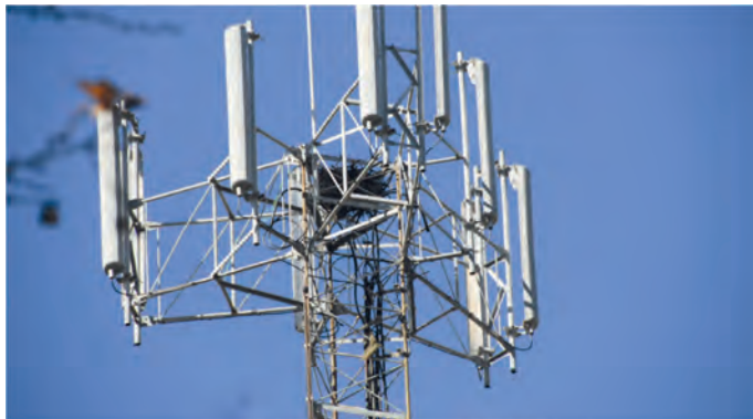
Εικόνα 2.5.β: Κεραία-σταθμός εκπομπής ασύρματου σήματος
